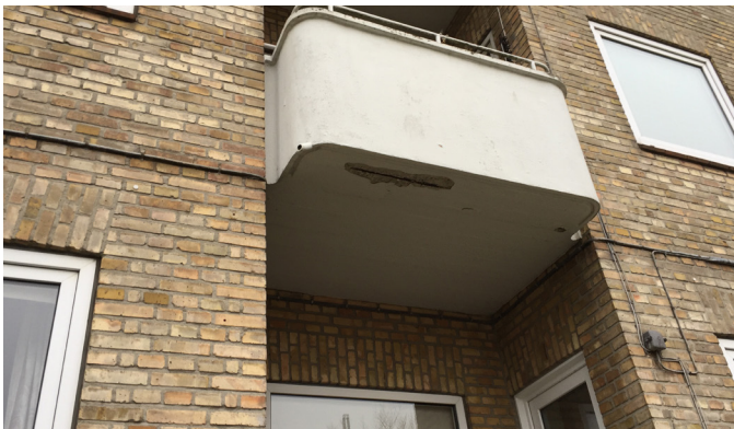
Eksisterende altan med betonskader
