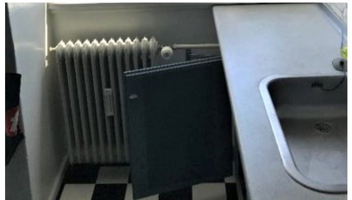
Eksisterende radiator i køkken
